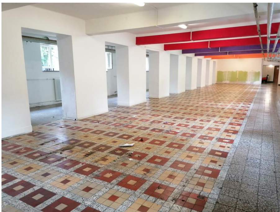
Stav podlahy v suterénu školy po vystěhování šatních skříněk
